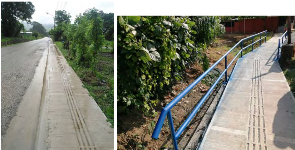
Proyecto: Construcción de acera en calle Renacimiento CAMINO: 6-05-306 Calles Urbanas Cuadrantes Barrio Renacimiento de Puerto Cortés
