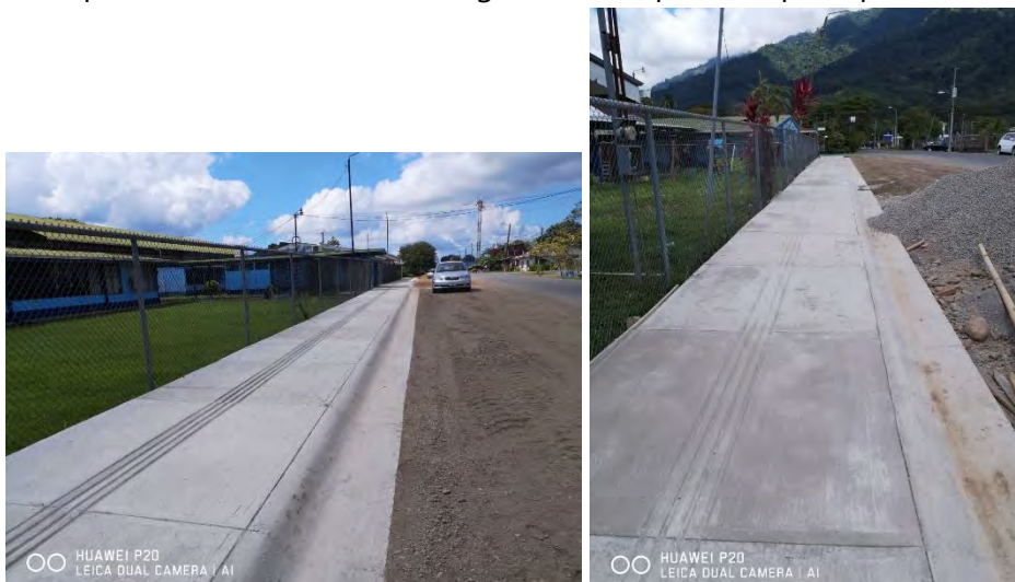
Construcción de aceras alrededor de la Escuela Eduardo Garnier de Palmar Norte.
