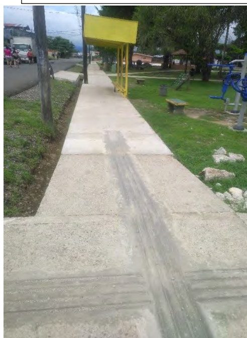
Reconstrucción de aceras perimetrales e internas del parque de Sierpe, mediante participación de ADI Sierpe, MOPT (ayudas comunales), Municipalidad de Osa y MTSS PRONAE.
