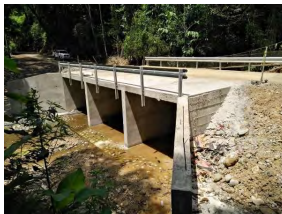
Proyecto de construcción de alcantarilla de cuadro mediante convenio con la ADI de Domaticalito. Inició 2020 y finalizó 2021.
